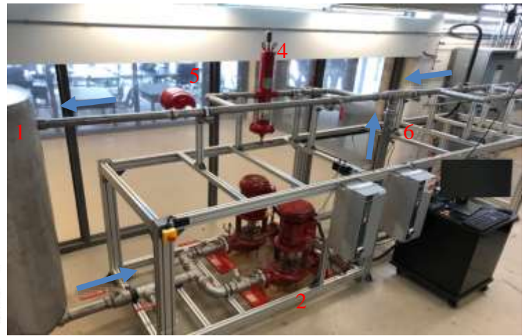
b) Actual Image of the pump setup
